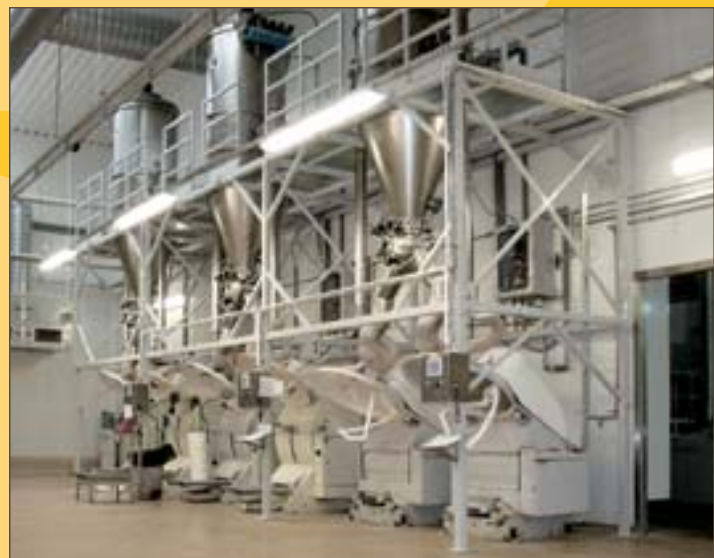
▲ EN Mixing department SL Oddelek za mešanje HR Odjel za miješanje PL Zagniatarka RU Зал смешивания ZH 混合料料室
